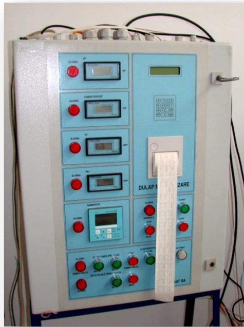
Panou de automatizare
