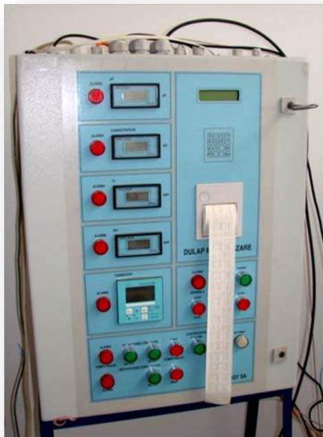
Panou de automatizare
