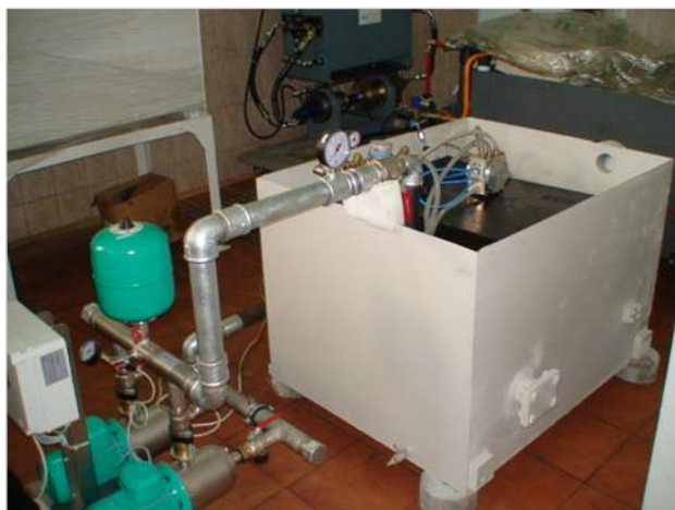
Fig. 4 Standul de probare echipamente si dispozitive hidraulice care utilizeaza apa ca fluid de lucru
